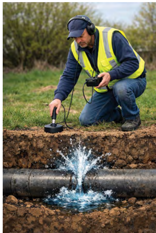
Controlo ativo de fugas de água com utilização de geofone
